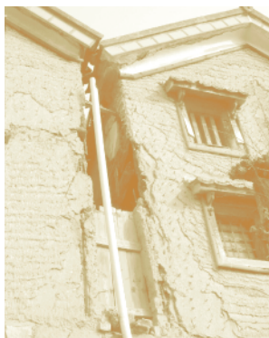
写真② 外壁が落ち、ひびが入つた三ツ蔵。
