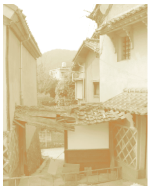
写真① 三ツ蔵と本蔵の間は瓦が崩落した。
