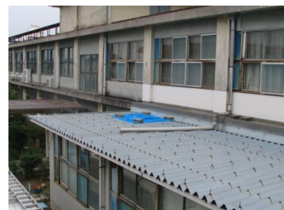
中間書庫の屋根（雨漏りした箇所）
