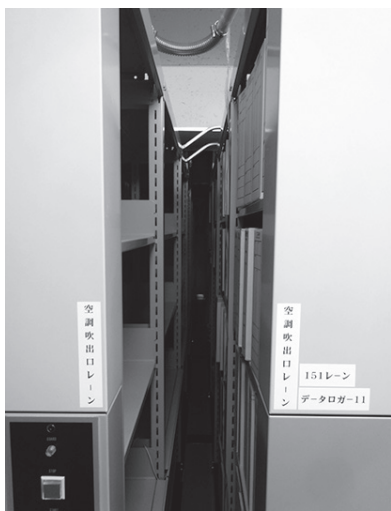
写真38 広めに開けたレイン（奥側が空調吹出口）
