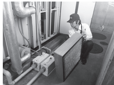
写真21 第5書庫の空調フィルター
