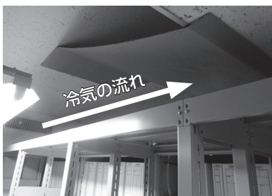
写真36 天井に取り付けた段ボール
