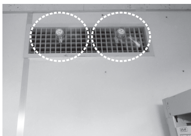
写真35 空調吹出口に取り付けた風車状のファン（2台）
