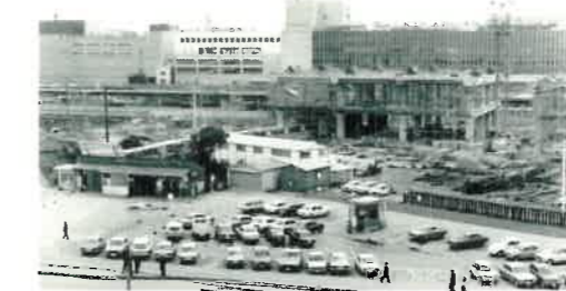
工事中の山陽新幹線広島駅(昭和48年1月27日) 駅北側から南方を望む。下に平屋建ての北口駅舎が見える。 200407-3575
