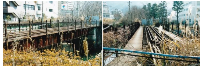
呉駅東方 堺川に架かる旧呉海軍工廠への引込線橋梁 平成16年1月18日(200407-5560) この鉄橋だけが、軍需鉄道だった呉線の生い立ちを今に伝えている。
