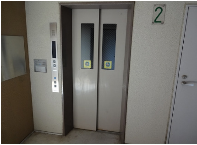
エレベーター
