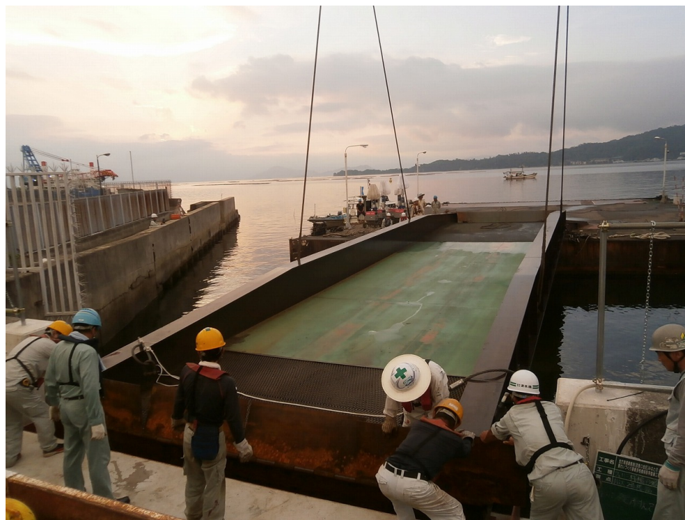
6:30連絡橋を設置し微調整。7:30からのカーフェリーの運航開始前に作業完了。
