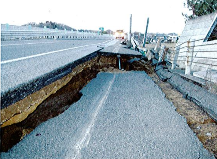
高速道路の被害状況（東北道～ネクスコ東日本より～）
