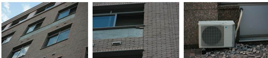
写真 外壁崩落現場
