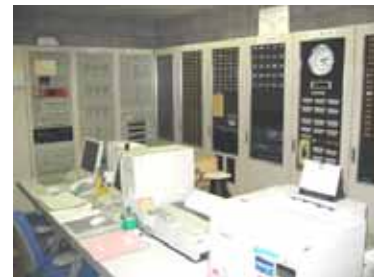
中央監視盤装置
