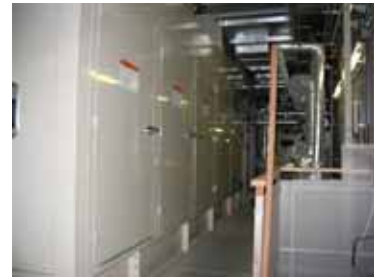
天然ガスコージェネレーション
