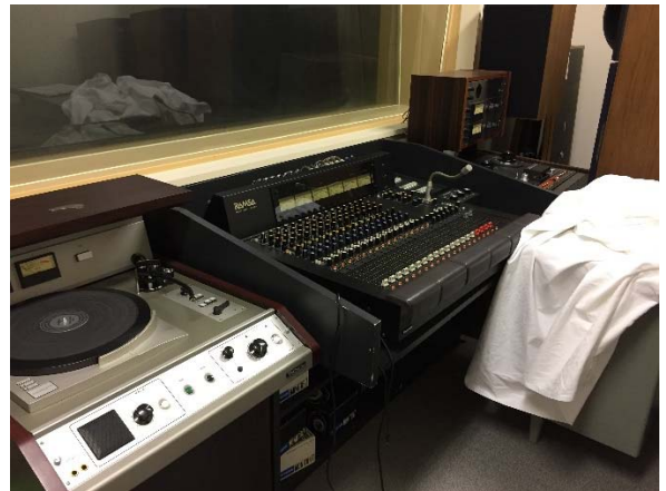
第3練習室の調整室に設置された録音機器
