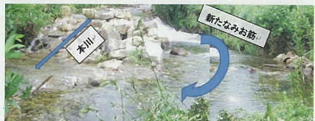
④堰の左岸が更に洗掘され淵や瀬を形成
