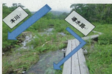
③取水堰のすぐ下で導水路が本川に流出
