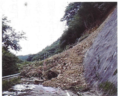
図2 林道の被災現場
