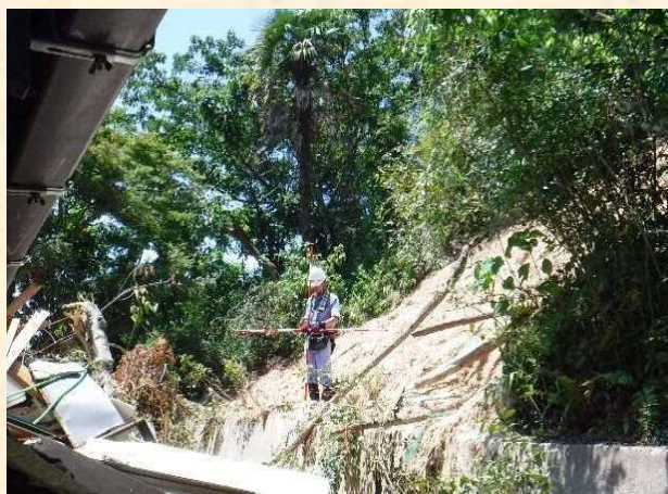
①崩壊状況
