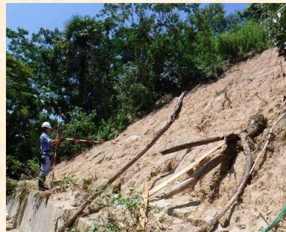
②崩壊状況
