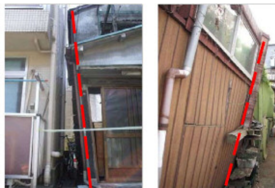
柱の変形が著しく倒壊の危険がある家屋(特定空家)
