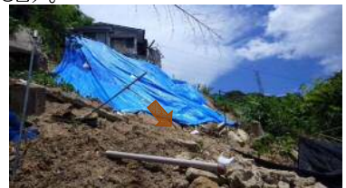
斜面崩壊・被災状況（H30年7月）
