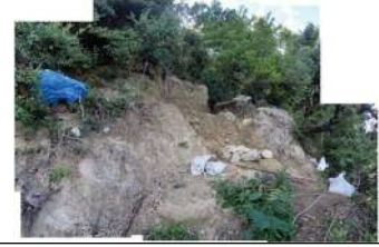
斜面崩壊・被災状況（H30年7月）
