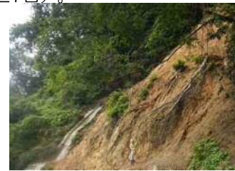
斜面崩壊・被災状況（H30年7月）
