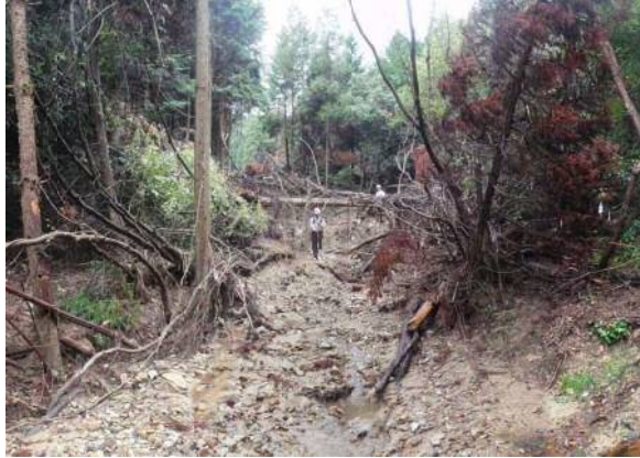
【工事前の溪流荒廃状況】
