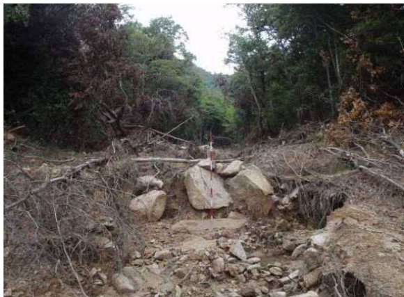
【工事前の溪流荒廃状況】
