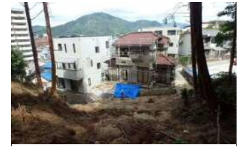
斜面崩壊・被災状況（H30年7月）
