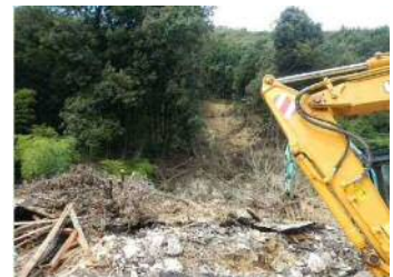
斜面崩壊・被災状況（H30年7月）
