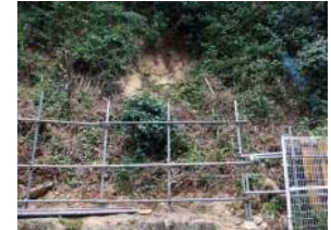
斜面崩壊・被災状況（H30年7月）
