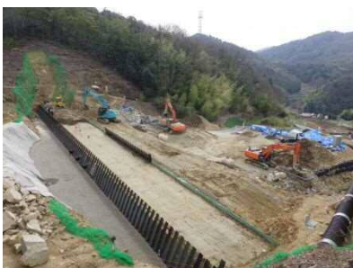
県砂防事業 中ヶ原川 (呉市安浦町)
