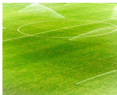
芝の散水設備
