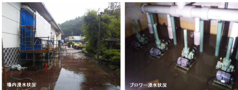
図2-18 向原浄化センター（安芸高田市）
