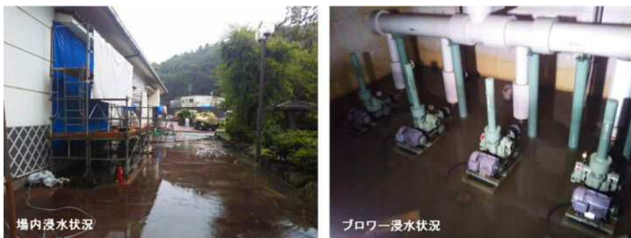
図2-18 向原浄化センター（安芸高田市）
