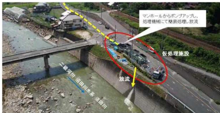
図2-17 沼田川流域下水道幹線（東広島市）
