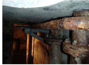
処理場内配管 腐食状況
