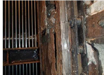
処理場機械 腐食状況
