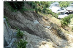
斜面崩壊・被災状況（H30年7月）
