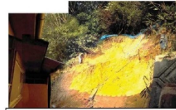
斜面崩壊・被災状況 （平成30年7月）
