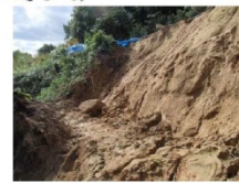
斜面崩壊・被災状況（H30年7月）
