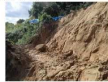
斜面崩壊・被災状況（H30年7月）
