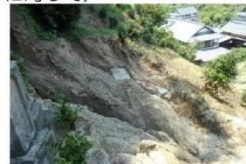
斜面崩壊・被災状況（H30年7月）
