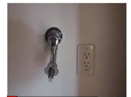
6 洗濯機用給水栓
