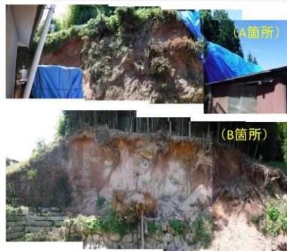
斜面崩壊・被災状況（H30年7月）
