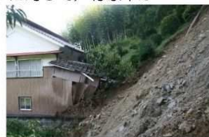
斜面崩壊・被災状況（H30年7月）
