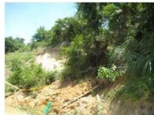
斜面崩壊・被災状況（H30年7月）
