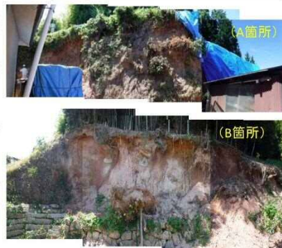
斜面崩壊・被災状況（H30年7月）
