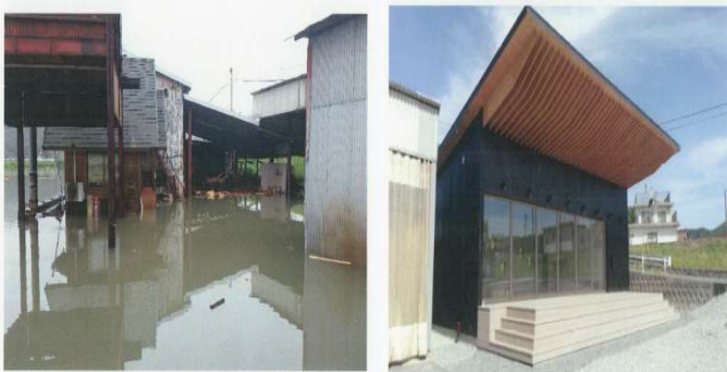
(復旧前) (復旧後) 新事業チャレンジ(グループ補助金)の状況(製造業) 製造工場にショールームを兼ねた作業場を新築
