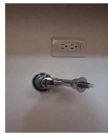
6 洗濯機用給水栓
