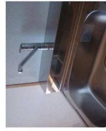
5 リフト・混合水栓
