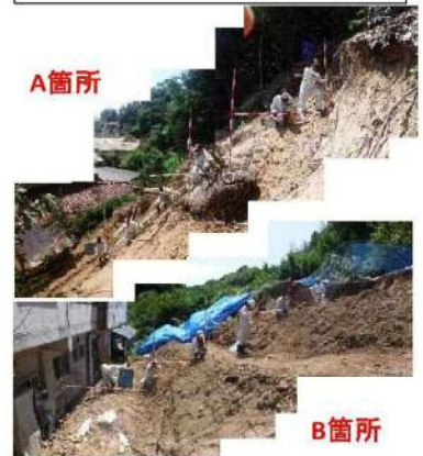
斜面崩壊・被災状況（H30年7月）
