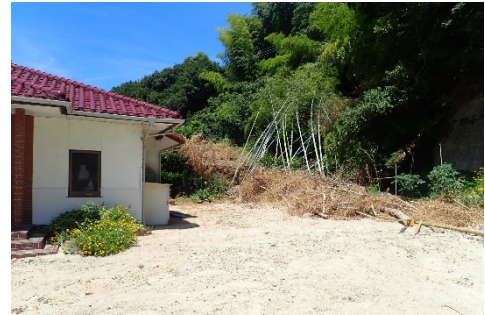
斜面崩壊・被災状況（H30年7月）
