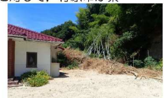
斜面崩壊・被災状況（H30年7月）
