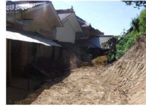
斜面崩壊・被災状況（H30年7月）
