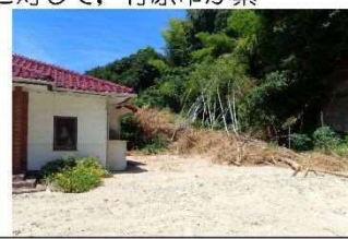
斜面崩壊・被災状況（H30年7月）
