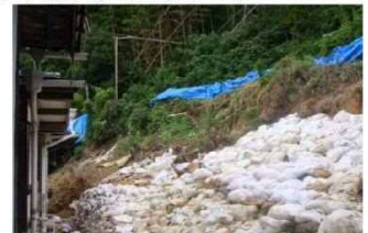
斜面崩壊・被災状況（H30年7月）
