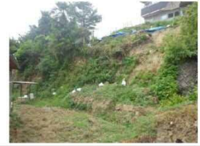
斜面崩壊・被災状況（平成30年8月）
