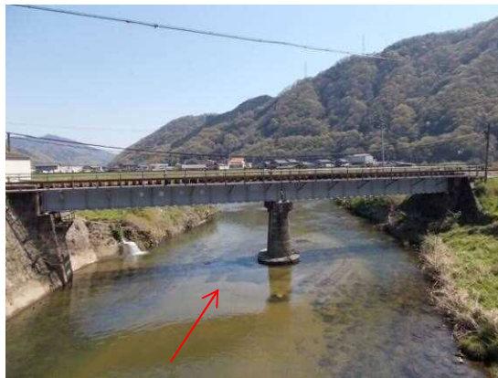
改修に伴い架替えを要する JR 鉄道橋梁
