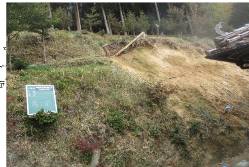
斜面崩壊・被災状況（H30年7月）
