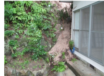
斜面崩壊・被災状況（H30年7月）
