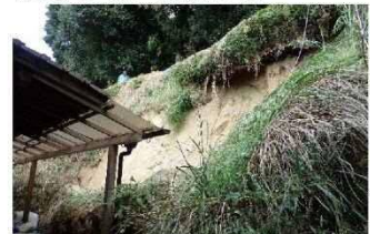
斜面崩壊・被災状況（H30年7月）
