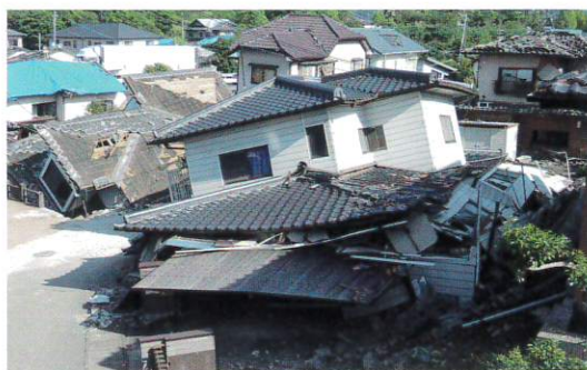
地震による被害例（熊本地震）
