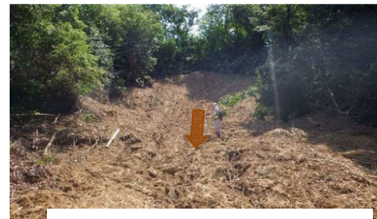
斜面崩壊・被災状況（H30年7月）
