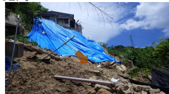
斜面崩壊・被災状況（H30年7月）
