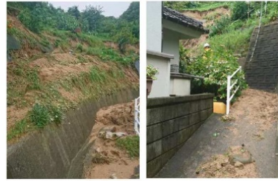
斜面崩壊・被災状況（平成30年7月）
