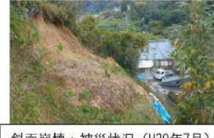
斜面崩壊・被災状況（H30年7月）
