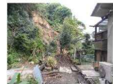
斜面崩壊・被災状況（平成30年7月）
