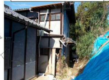
斜面崩壊・被災状況（H30年7月）
