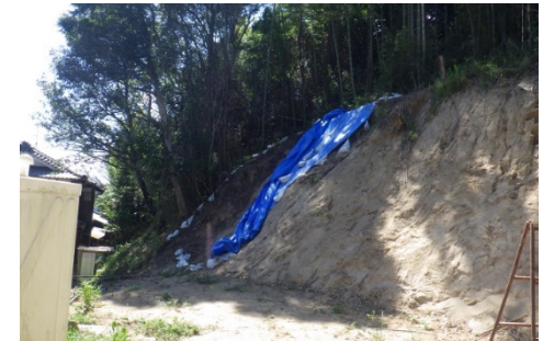
斜面崩壊・被災状況（H30年7月）
