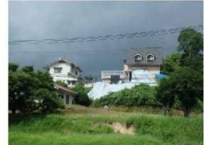
斜面崩壊・被災状況（平成30年8月）
