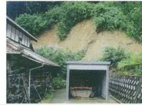
斜面崩壊・被災状況（平成30年8月）
