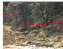
石積砂防堰堤の被災
