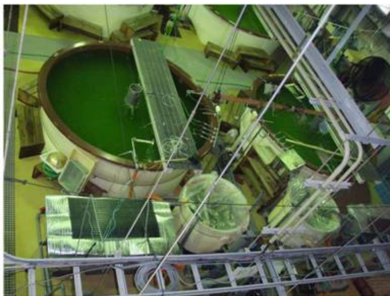
写真1.水産海洋技術センターに導入している閉鎖循環ろ過システム
