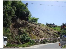
斜面崩壊・被災状況（H30年7月）
