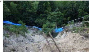
斜面崩壊・被災状況（H30年7月）
