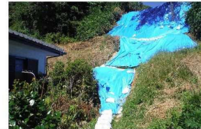
斜面崩壊・被災状況（H30年7月）
