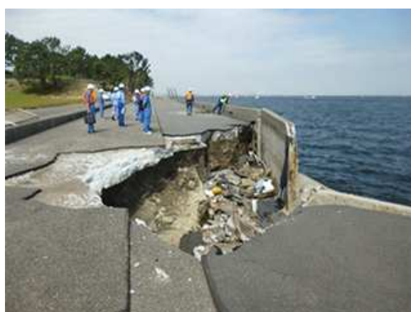
令和元年房総半島台風により被災した護岸 (出典:国土交通省関東地方整備局)
