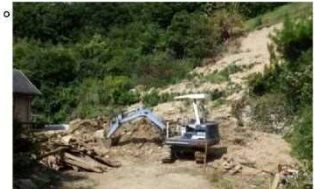
斜面崩壊・被災状況（H30年7月）
