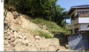
斜面崩壊・被災状況（H30年7月）
