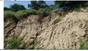
斜面崩壊・被災状況（H30年7月）
