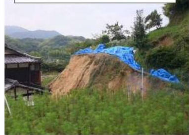
斜面崩壊・被災状況（H30年7月）
