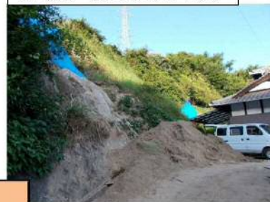
斜面崩壊・被災状況（H30年7月）
