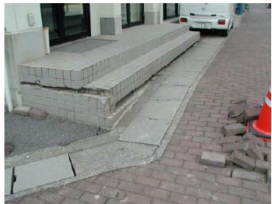
H13 芸予地震による液状化（広島港海岸）
