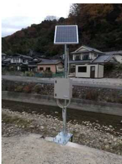
【簡易型河川監視カメラ設置例】
